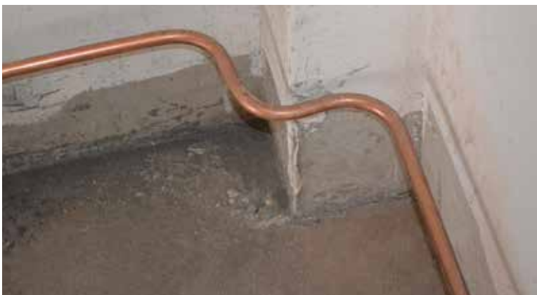
Equipotential grounding conductor
